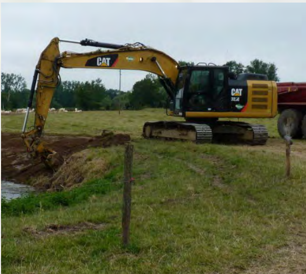
Travaux en 2018 sur les bras et digue de la Reyssouze à Cras
